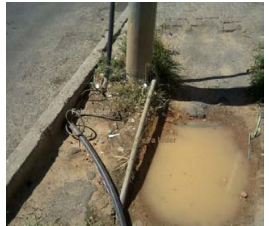
Foto 2 - Descaso de instalações
