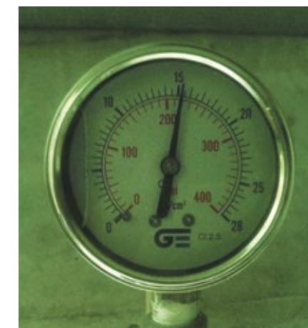
Figura 2 - Manômetro indicando a pressão do sistema
